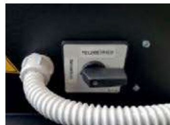
Umschalter Feld- und Einspeisebetrieb.
